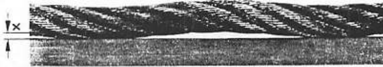
Bild 1. Drahtseil mit korkenzieherartiger Verformung
